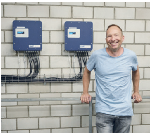
Roger Hägi, Instandhaltungsplaner Produktion WVZ, vor den Messumformern der Ductus S Systeme
